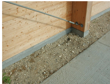
Punkt- og sribefundamenter er opbygget af præfabrikerede betonelementer. Massive træelementer udgør ydervæggene.
